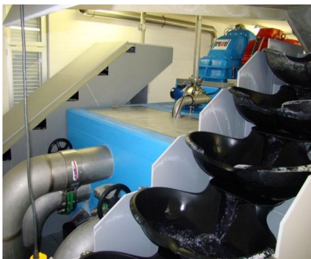
Figure 15 : station de captage, Giubiasco Suisse ; Crédit photo Aïga Terra
