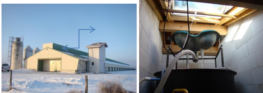
Figure 10 : Installation d'une Vasque Vive sur l'eau d'abreuvement d'un élevage de 9000 poules Crédit photo Aïga Terra
